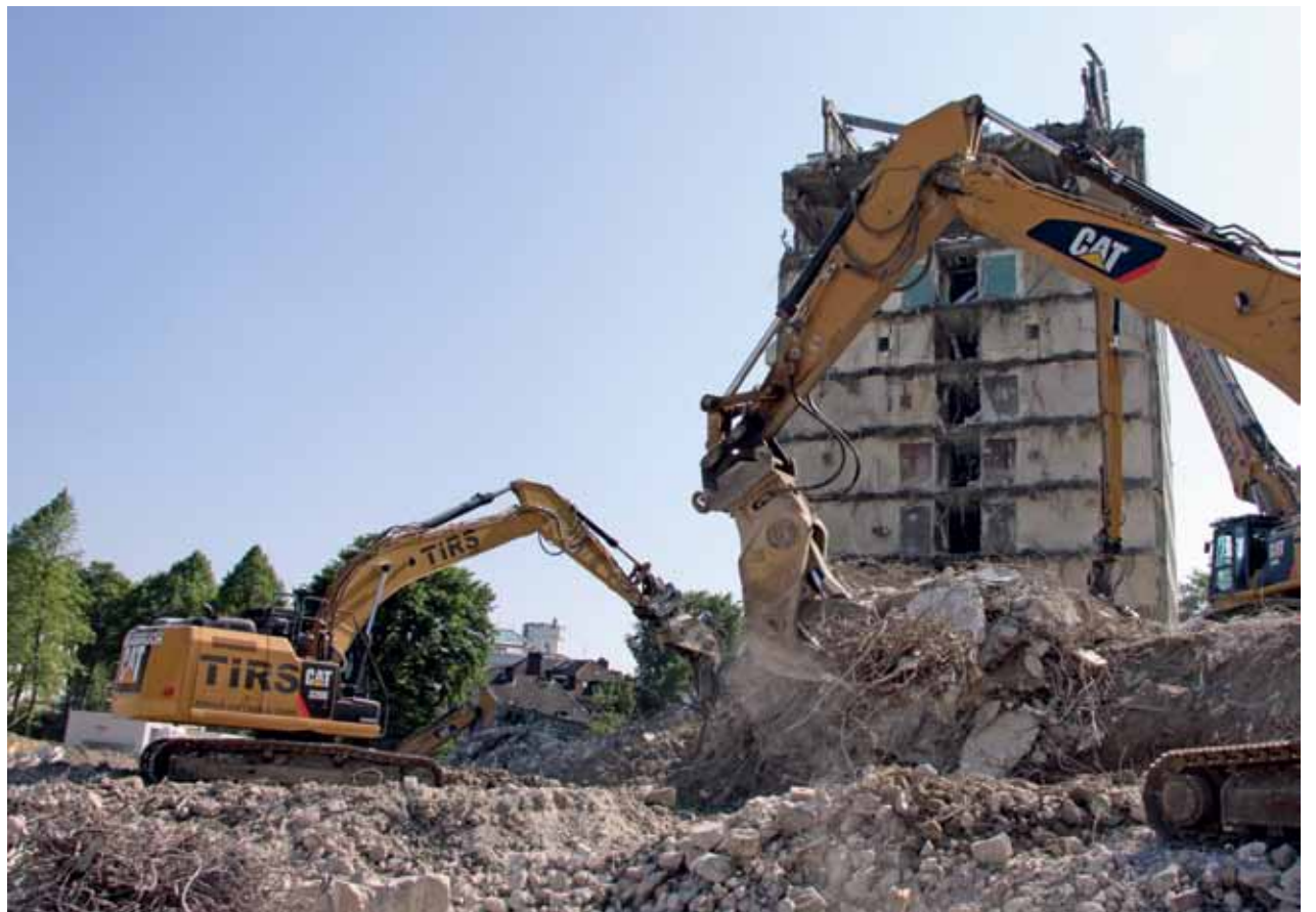
Der neue Cat Kettenbagger 349EL übernahm den gezielten Rückbau, während sich die anderen Baumaschinen den Nacharbeiten und dem Recycling widmeten. Fotos (4): Zeppelin
